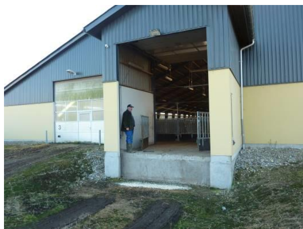
Et lille fald i terrænet udnyttes fint. Lastbilen kører lidt ned, og dyrene skal kun gå ca. 20 cm op. Bemærk at der er sensorstyret lys over porten, som kan åbnes både inde- og udefra.
